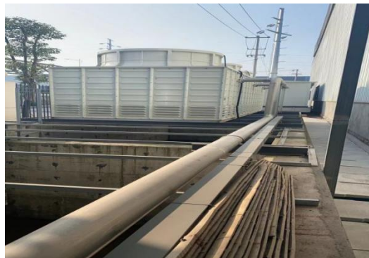
冷却循环水塔、循环水池
