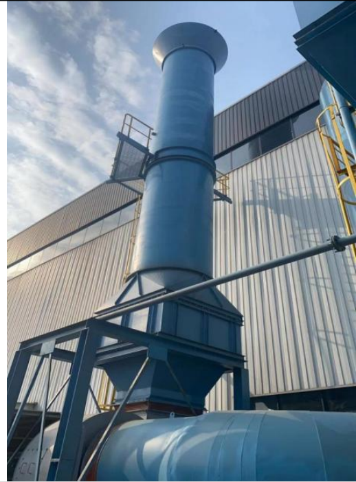
综合回收车间排气筒 (DA003)
