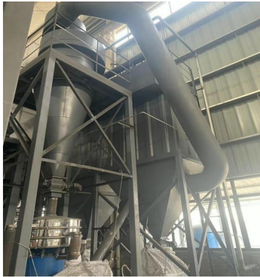
硅粒车间 1#除尘设施
