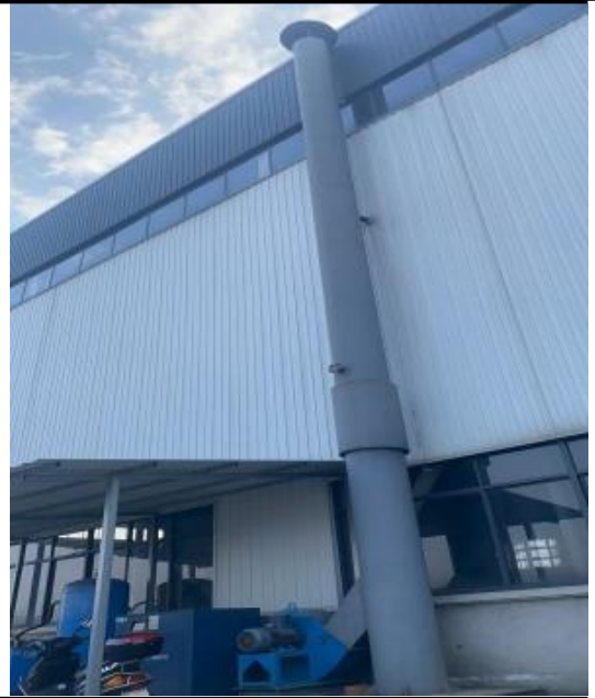
硅粒车间 DA001 排气筒
