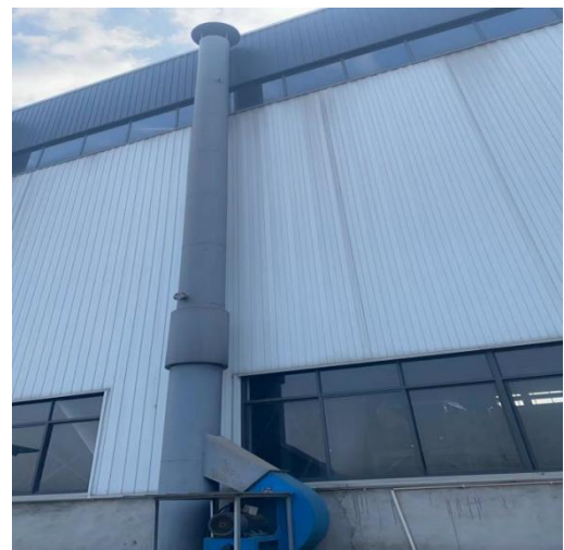
硅粒车间排气筒 (DA002)
